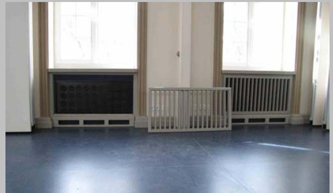
Quellluftauslässe unterhalb der Fensterbrüstung
