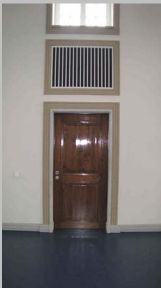
Ablufteinlass über einer Tür
