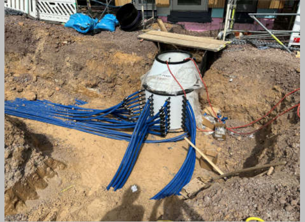
Sondenverteiler bei Druckprobe
