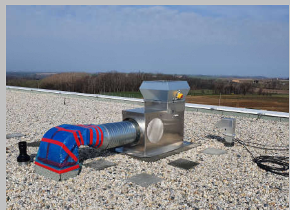
Abluftventilator Klassenraumlüftung (Dichtheitsprobe)
