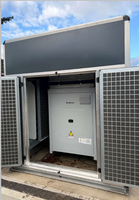
Luft-Wasser-Wärmepumpe (Buderus) mit Schalldämmhaube
