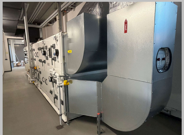
Lüftungsanlage Küche 4.900 m3/h
