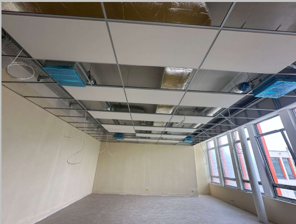
Klassenraumlüftung mit adiabater Kühlung
