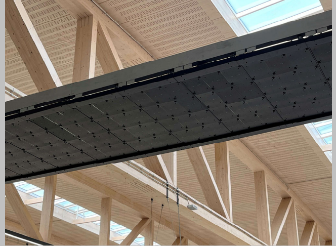
Gebäude in Hybrid- Holzbauweise Vordergrund: Infrarot-LED-Heizband über Tribüne
