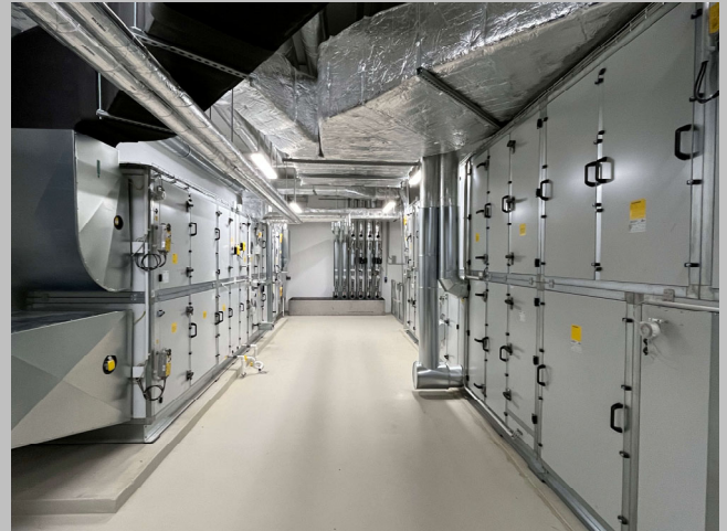
Lüftungszentrale mit RLT1 und RLT2
