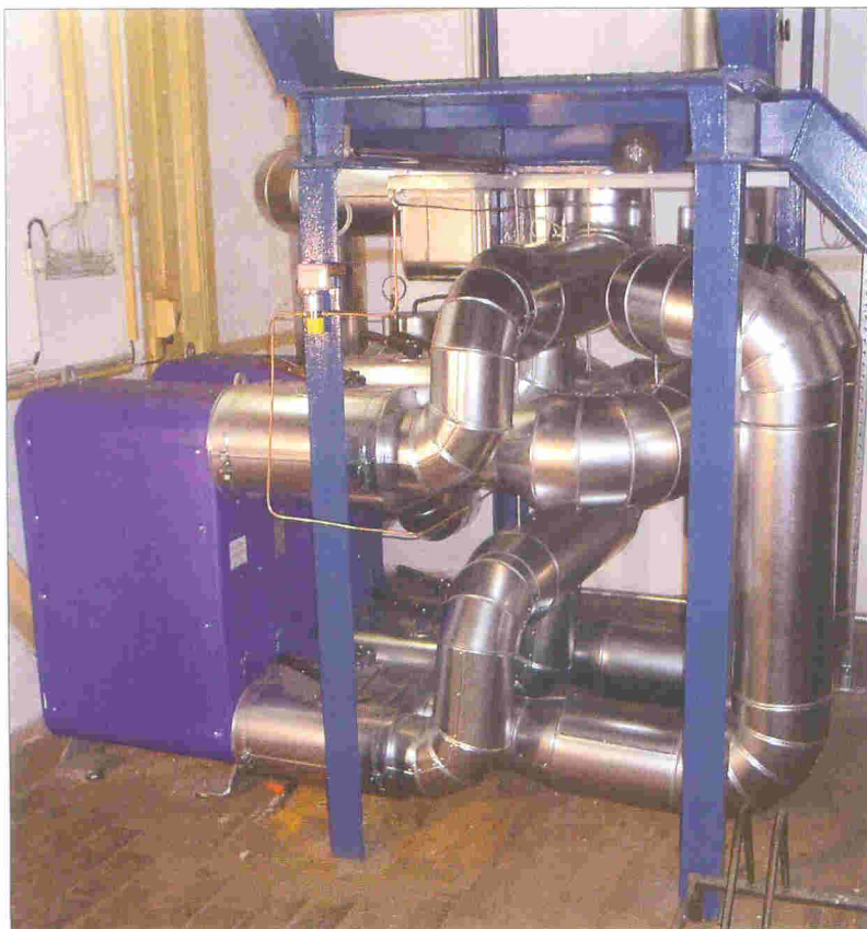
Bild 6. Wärmeübergabestation bei SFF
